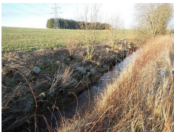
Figur 5.23. Ved Kvernhussholen er den ene kanalkanten skrådd, men den andre ikke i like stor grad. Begge sider bør være skrå og det bør etableres terskler langs hele denne strekningen.
